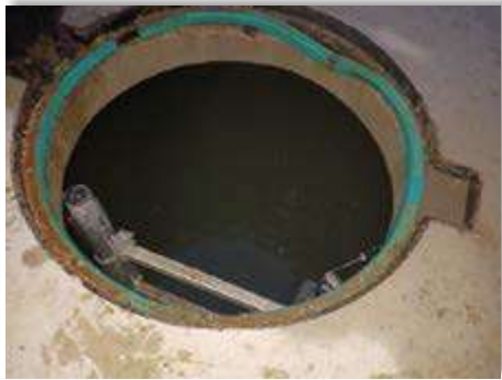
Janvier : Chambre à vanne noyée
